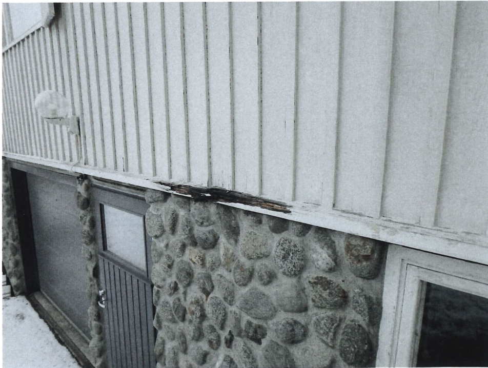
Kuva 4: Ulkoverhouslauta/tippalista osittain lahovaurioitunut.
